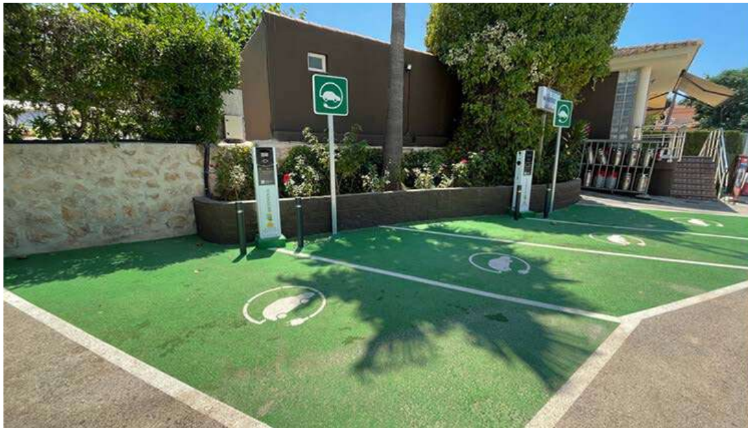
PUNTO DE RECARGA VEHÍCULOS ELÉCTRICOS
